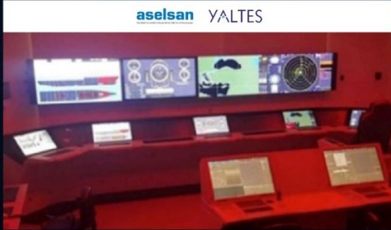
Köprü Üssü Kontrol Sistemleri
